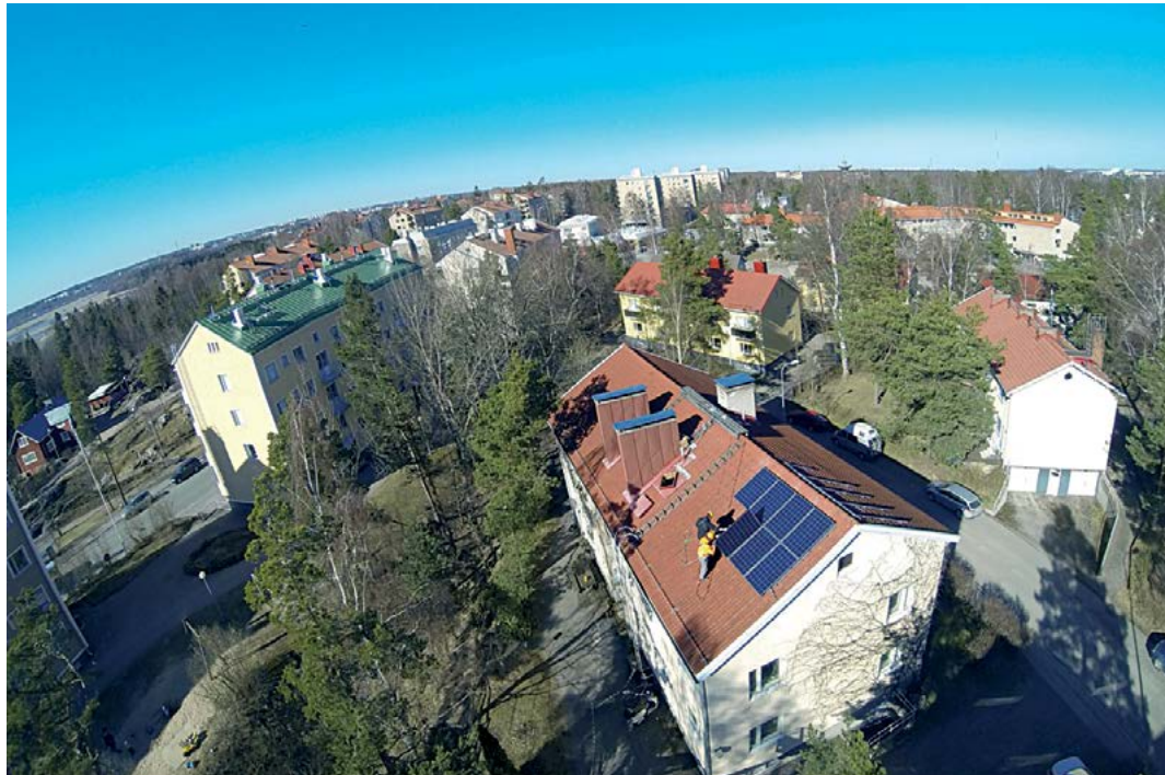
Suomen ensimmäinen kerrostalossa asukkaan käytössä oleva aurinkosähköjärjestelmä Herttoniemessä. Asennus: Playgreen Finland Oy. Kuva: Janne Käpylehto
